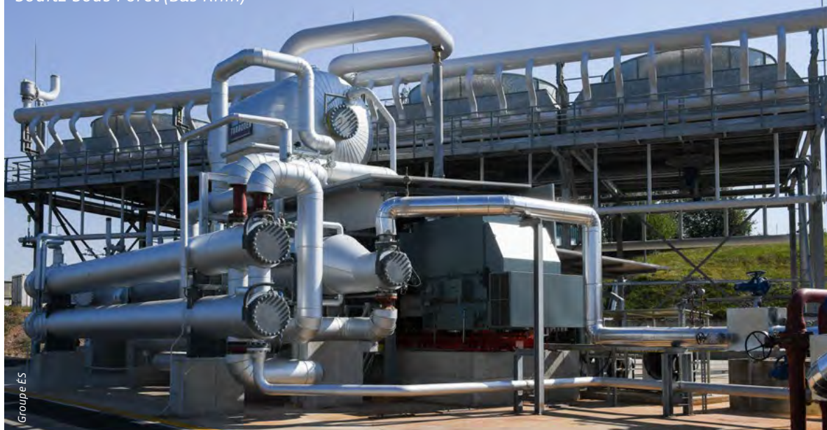
Centrale géothermique de Soultz-Sous-Forêt (Bas-Rhin)
